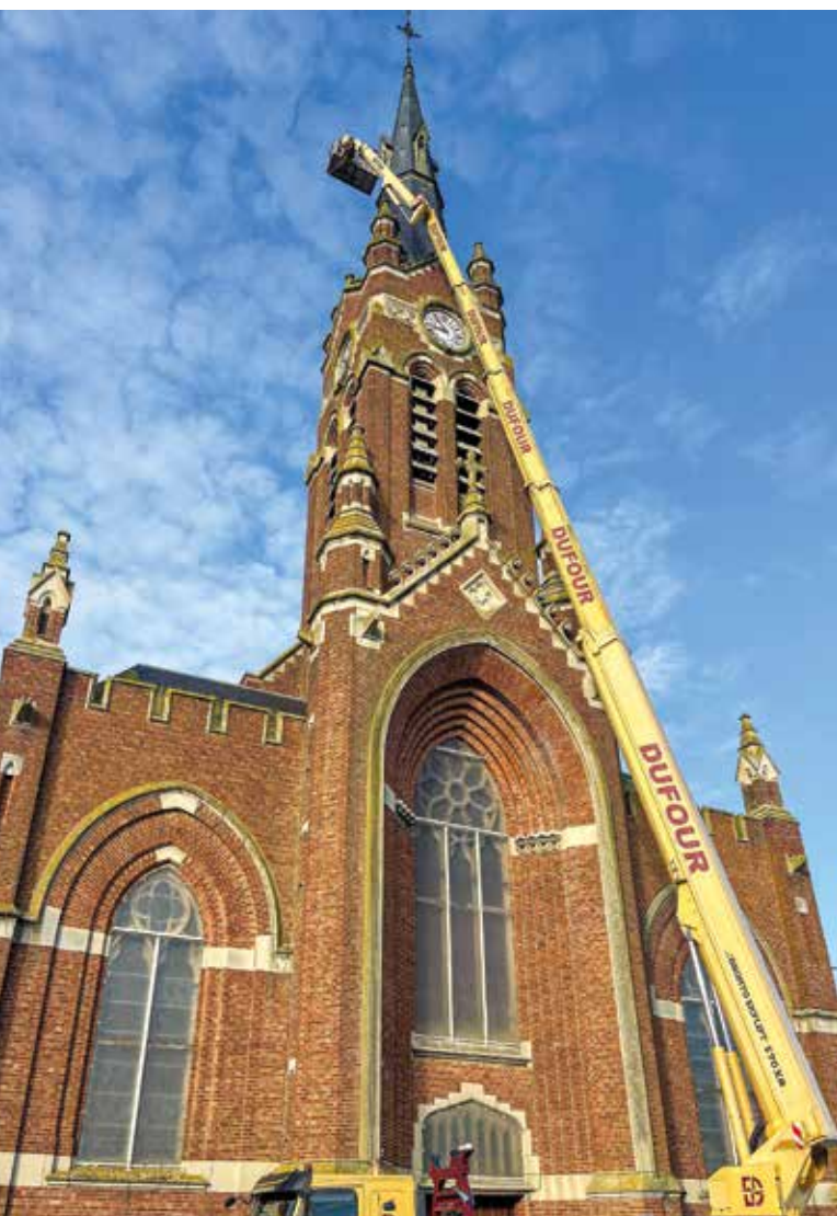
→ Diagnostic de l'état des 4 lucarnes hautes du clocher de l'église St Barthélémy.
