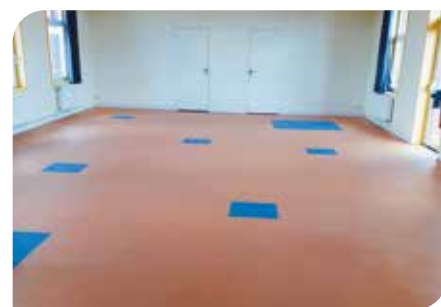
→ Vitrification du revêtement de sol de la salle jaune de l'Espace Louis de Berquin.
